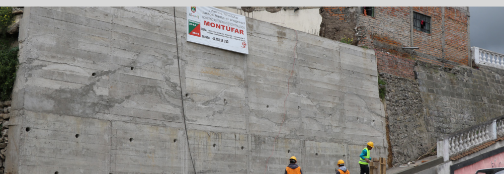
Adecuación y reconstrucción de descarga del sistema de alcantarillado de la carrera Montúfar, entre Rumichaca y Atahualpa 5.052,74 usd
